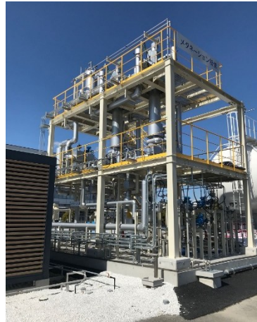
B. メタネーション実証実験 東京ガス横浜テクノステーション
